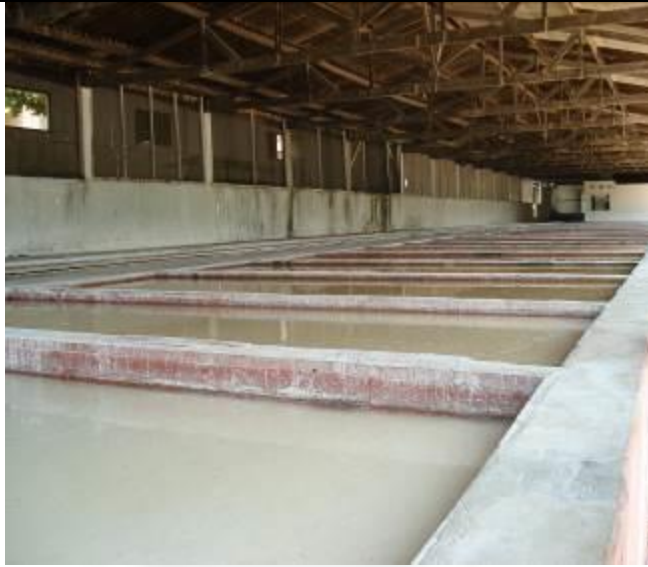
Foto 05. Tanques de decantação
