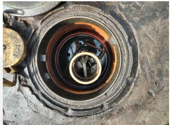
Foto 2: Boca de descarga, onde se vê válvula antitransbordamento
