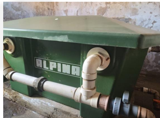
Foto 6: Caixa separadora de água e óleo
