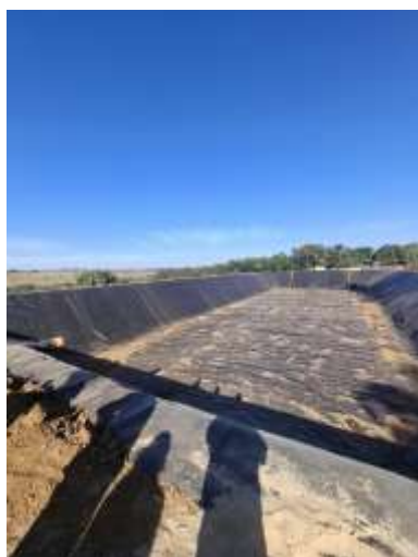
Foto 1: Lagoa de tratamento
