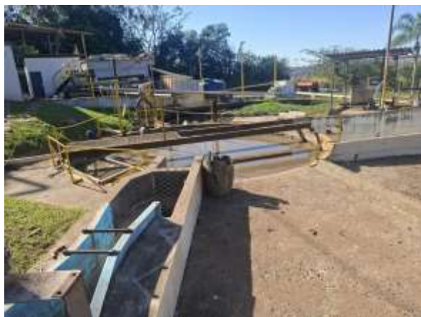
Foto 3: Parte da ETE existente
