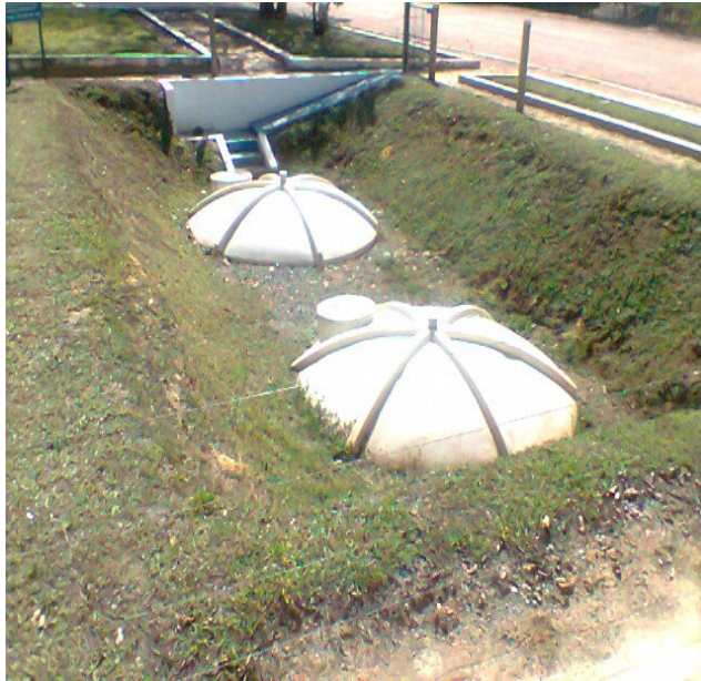
Foto III– Sede/fossa Séptica e sumidouro
