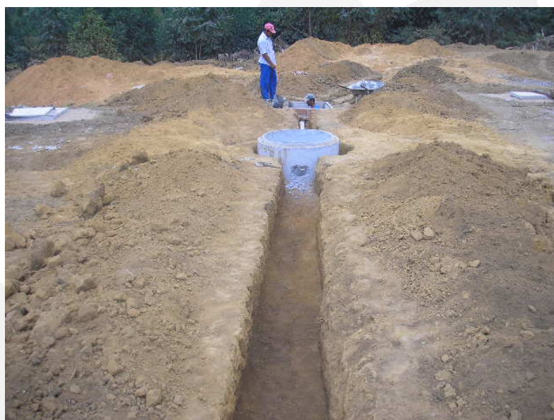
Foto 4. Instalações do tratamento de esgoto.
