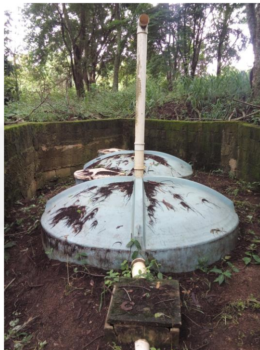
Imagem 2: tratamento de efluentes sanitários
