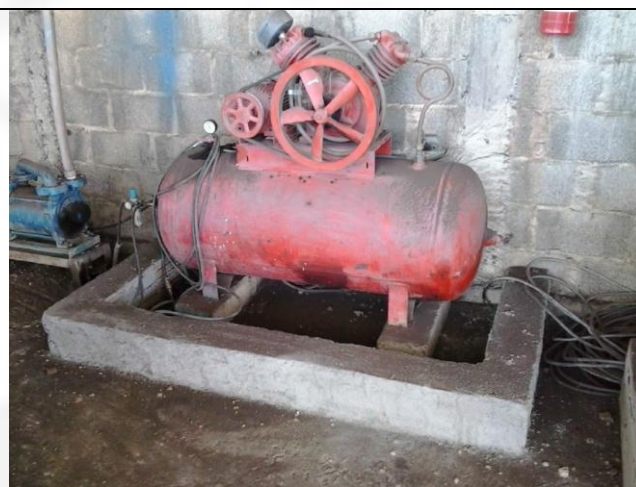
Foto 06. Compressor com bacia de contenção e piso impermeável
