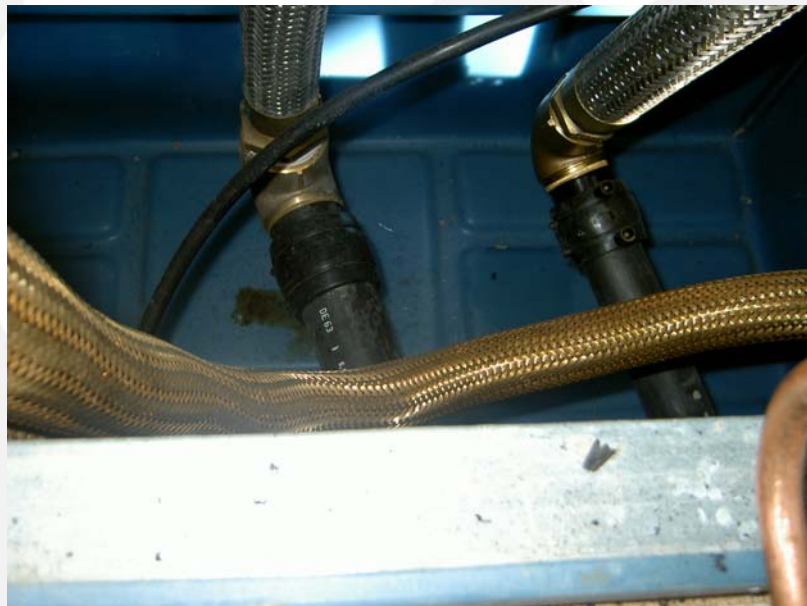
Foto 04: Tubulação em PEAD.
