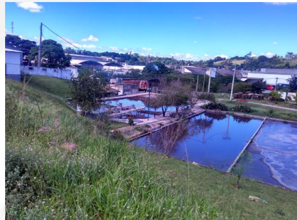
Lagoa anaeróbica e decantadores secundários Foto 02.
