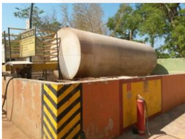
Foto 03. Posto de abastecimento com caixa de contenção
