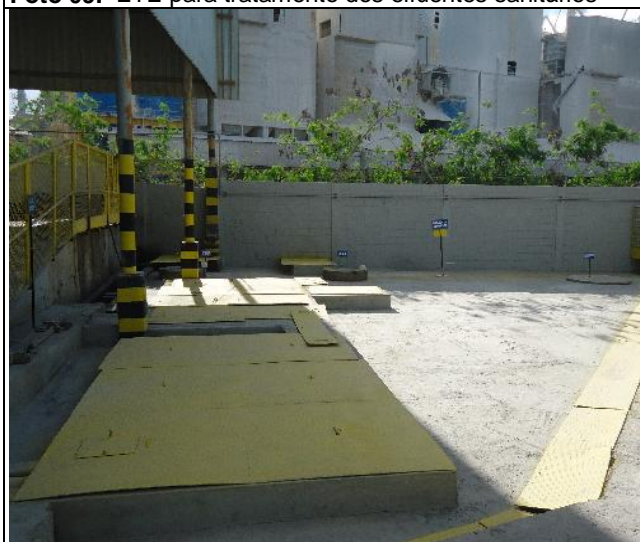
Foto 11. Caixa separadora água/óleo
