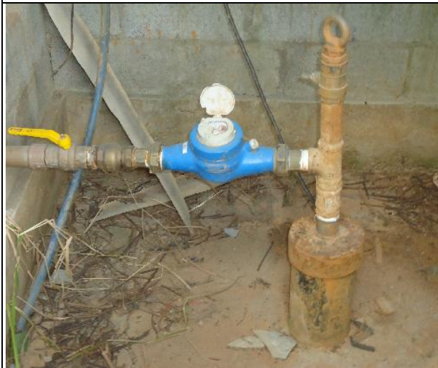
Foto 07. Poço tubular com hidrômetro instalado.
