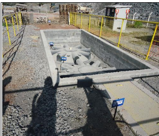
Foto 09. ETE para tratamento dos efluentes sanitários
