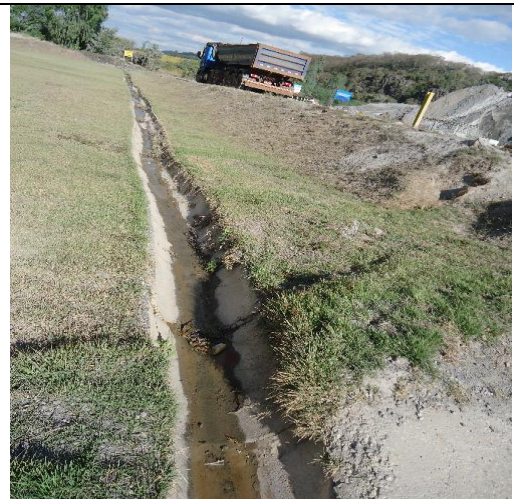
Foto 08. Sistema de drenagem pluvial instalado.
