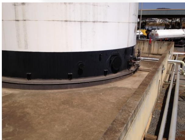
Foto 03. Bacia de contenção da área de tancagem
