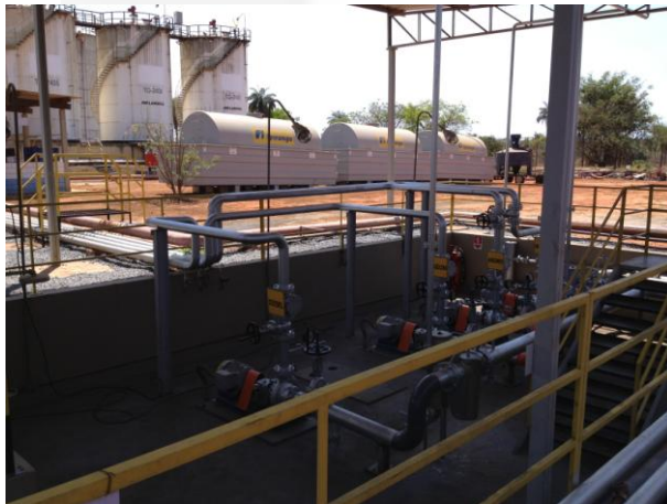
Foto 07. Praça de bombas
