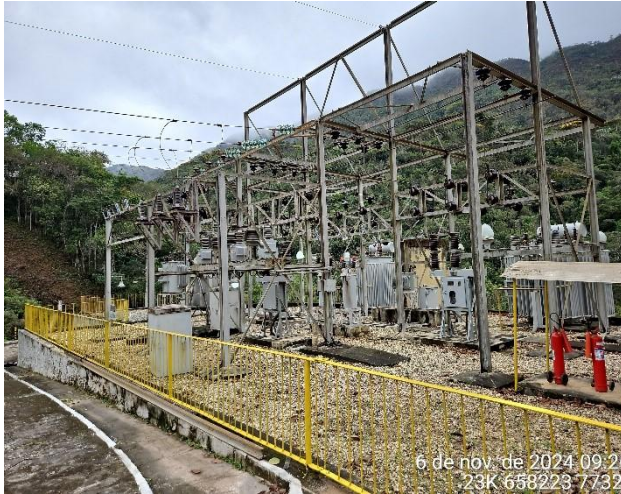
Foto 31: Subestação da CGH Caboclo.
