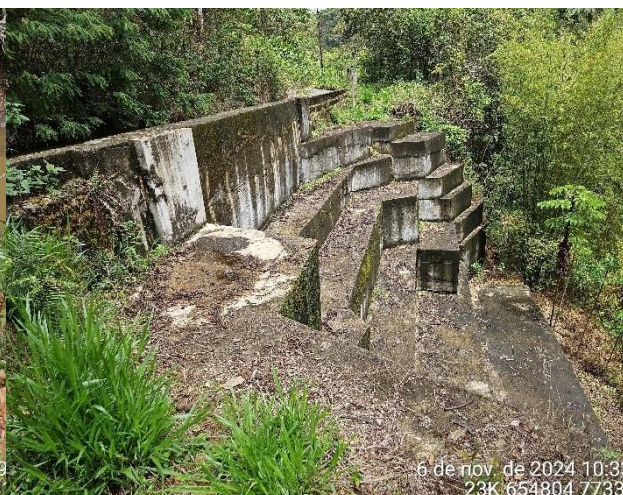
Foto 14: Estrutura de alvenaria construída para reconformação do canal e estabilização do talude.
