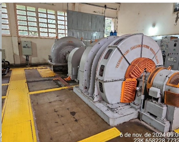
Foto 18: Sala das Turbinas da Casa de Força da CGH Caboclo.
