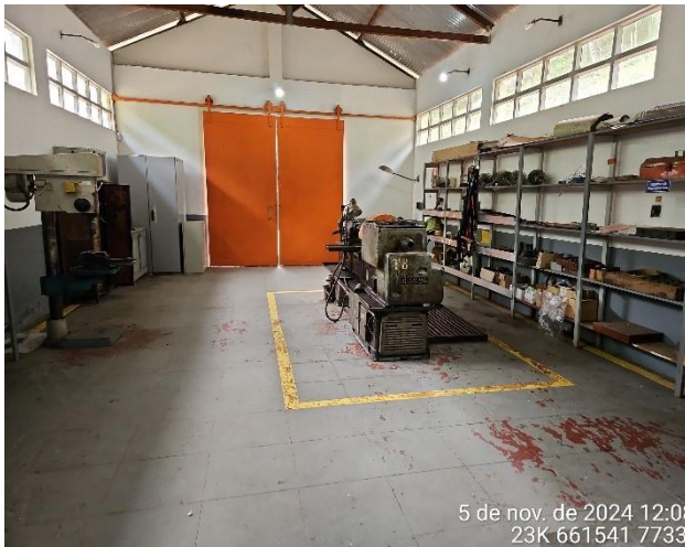
Foto 21: Oficina eletromecânica na Casa de Força da CGH Salto.
