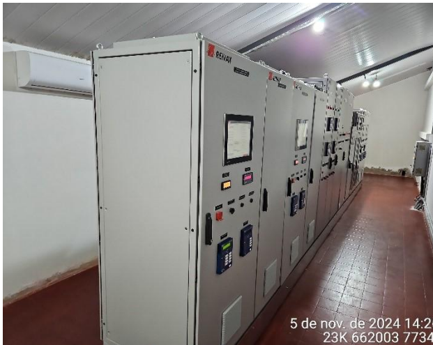
Foto 27: Painéis de controle da Casa de Força da CGH Funil.
