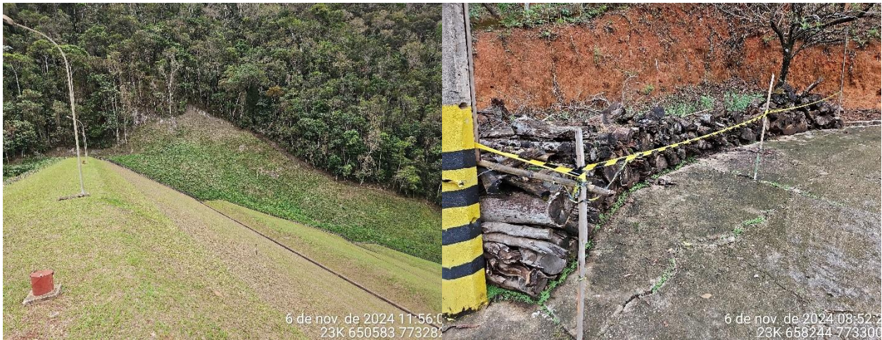
Foto 43: Área onde ocorreu a supressão das árvores na ombreira esquerda da barragem do Ribeirão Cachoeira.
