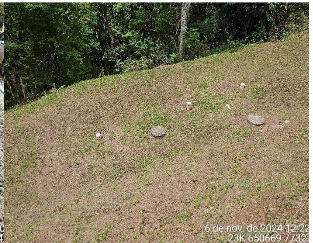
Foto 36: Fossa séptica para atender às estruturas na barragem do Ribeirão Cachoeira.
