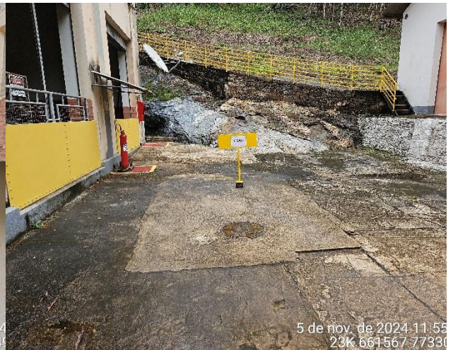
Foto 40: CSAO associada aos transformadores da CGH Salto.
