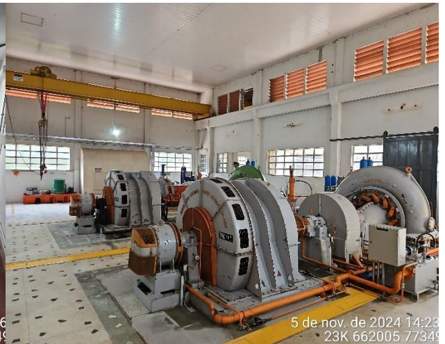
Foto 28: Sala de máquinas da Casa de Força da CGH Funil.
