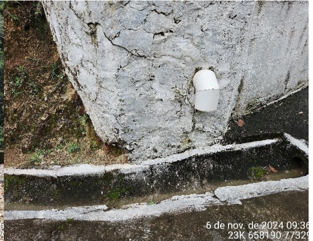
Foto 38: Saída de efluente da CSAO da Subestação Caboclo
