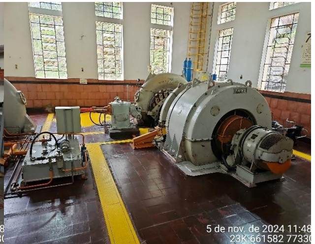
Foto 22: Sala de máquina na Casa de Força da CGH Salto.
