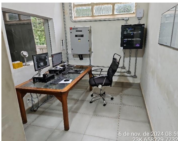
Foto 17: Sala de operação da Casa de Força da CGH Caboclo.
