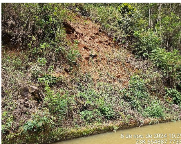
Foto 11: Encosta instável na margem do canal de adução.
