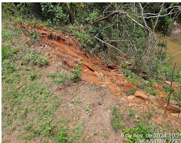
Foto 13: Talude instável, com indícios de desmoronamento recente.
