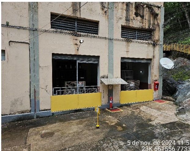
Foto 23: Comodos com os transformadores da Casa de Força da CGH Salto.
