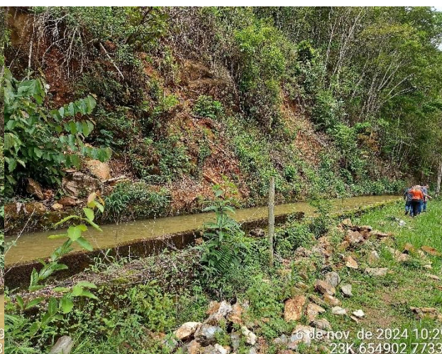
Foto 12: Ponto com indício de ocorrência de desabamento da encosta.
