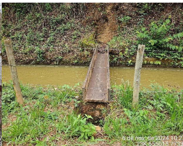
Foto 10: Bicame para transposição de água de escoamento superficial.
