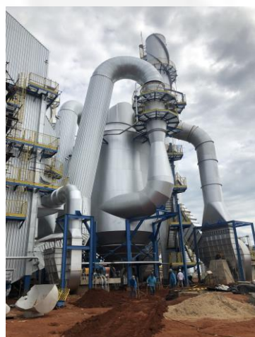
Foto 03. Lavador de gases da nova caldeira
