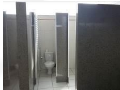
Foto 02. Sanitários já existentes e ligados à rede da COPASA.
