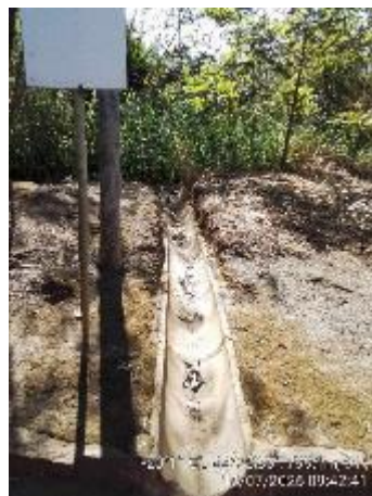
Foto 08. Sistema de drenagem pluvial.
