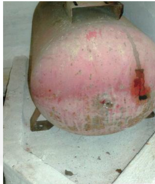
Foto 15: Compressor com bacia de contenção.
