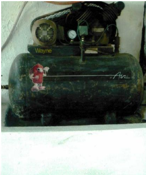
Foto 14: Compressor com bacia de contenção.
