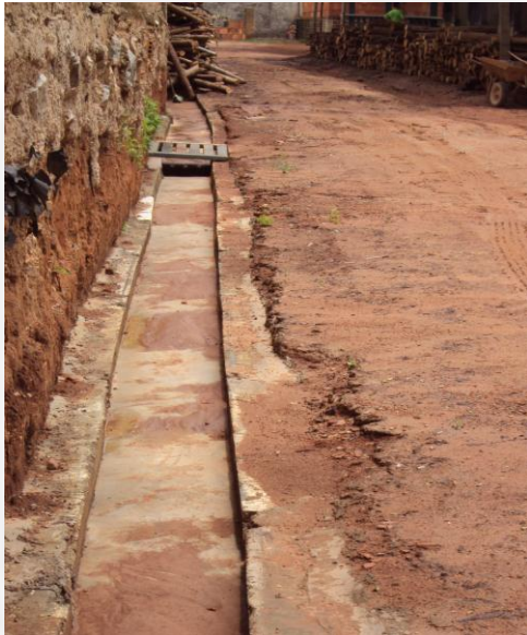
Foto 12: Canaleta e caixa de sedimentação do sistema de drenagem pluvial.
