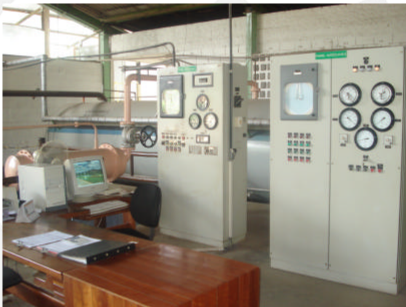
Foto 8-Local Onde é Feito o Controle das Autoclaves
