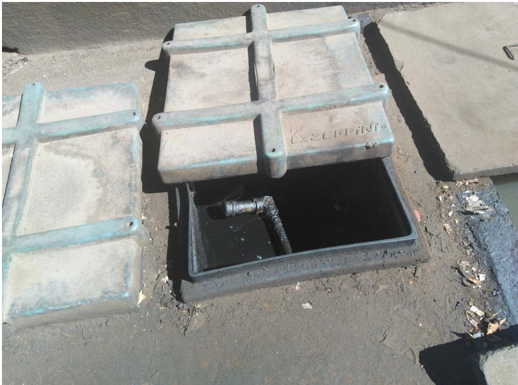
Imagem 3 – Falta de manutenção da caixa SAO
