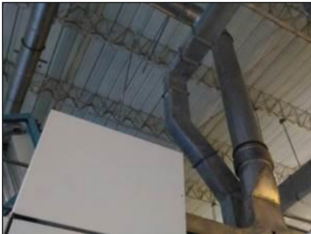
Foto 05. Sistema de exaustão interligado aos filtros de Viledon (manta)
