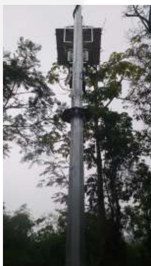
Foto 03. Sirene instalada próxima a barragem
