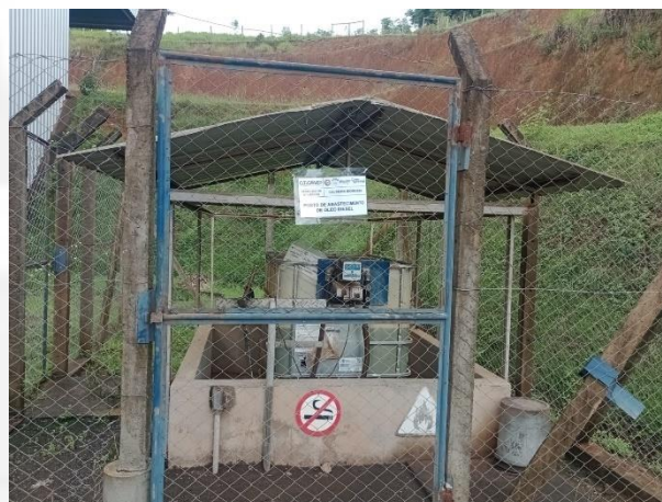
Foto 02. Ponto de abastecimento de óleo diesel
