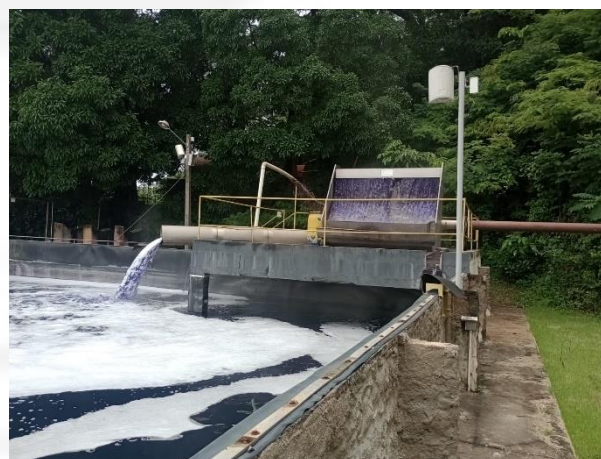
Foto 10. Entrada dos efluentes na ETE
