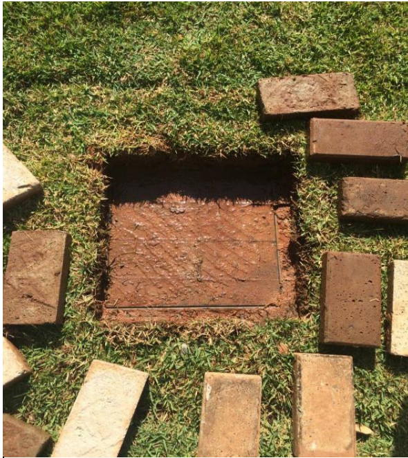
Foto 5 - Saída do filtro anaeróbio
