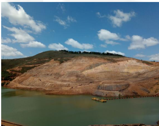
Foto 03. Estrutura para recirculação de água
