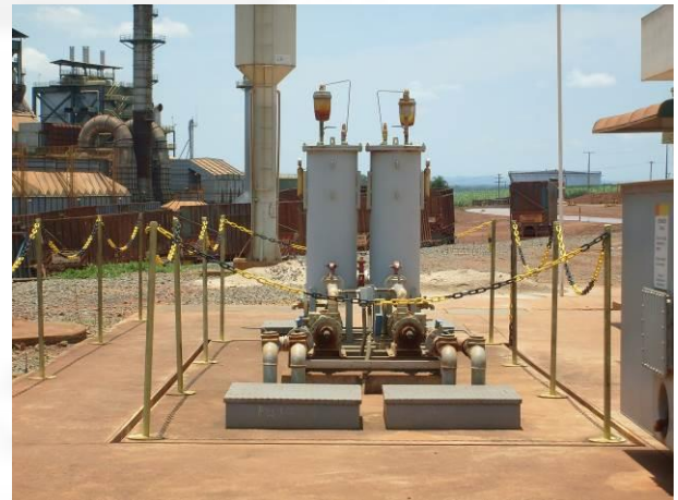
Foto 02. Área dos filtros de Diesel
