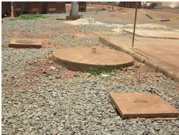
Foto 07. Tanque de armazenamento do efluente sanitário
