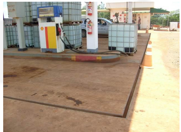
Foto 04. Canaletas na pista de abastecimento
