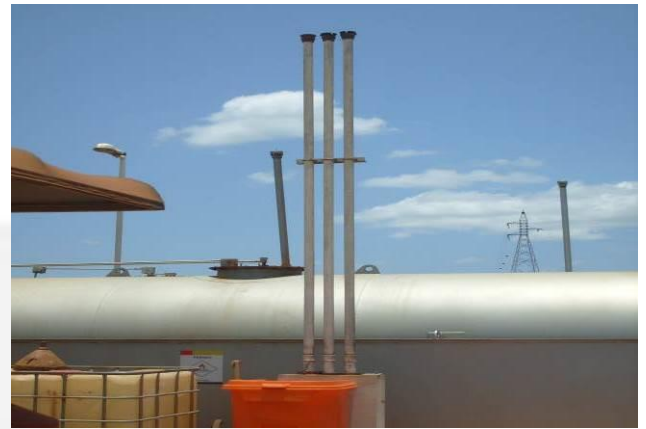
Foto 06. Tubulação de respiro dos tanques subterrâneos
