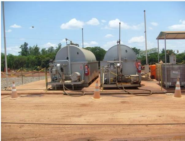
Foto 01. Tanques aéreos e boca de descarga dos tanques subterrâneos (indicado pelos cones)
