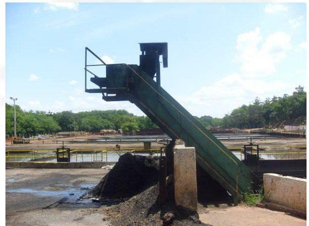
Foto 08. Estação de tratamento dos efluentes de toda a planta industrial
