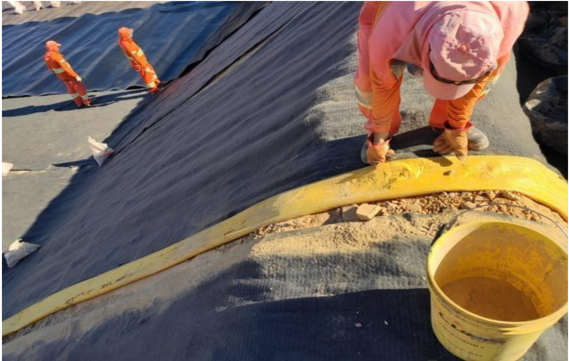
FIGURA 06 – Geocomposto beonítico (GCL) sendo instalado na unidade operacional da UVS VIASOLO MONTES CLAROS.
