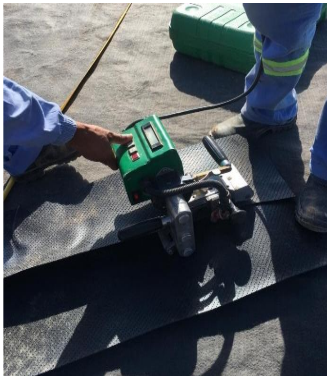
FIGURA 10 – Procedimento de solda, por termofusão da geomembrana de PEAD durante sua instalação em unidade operacional da UVS VIASOLO MONTES CLAROS.
