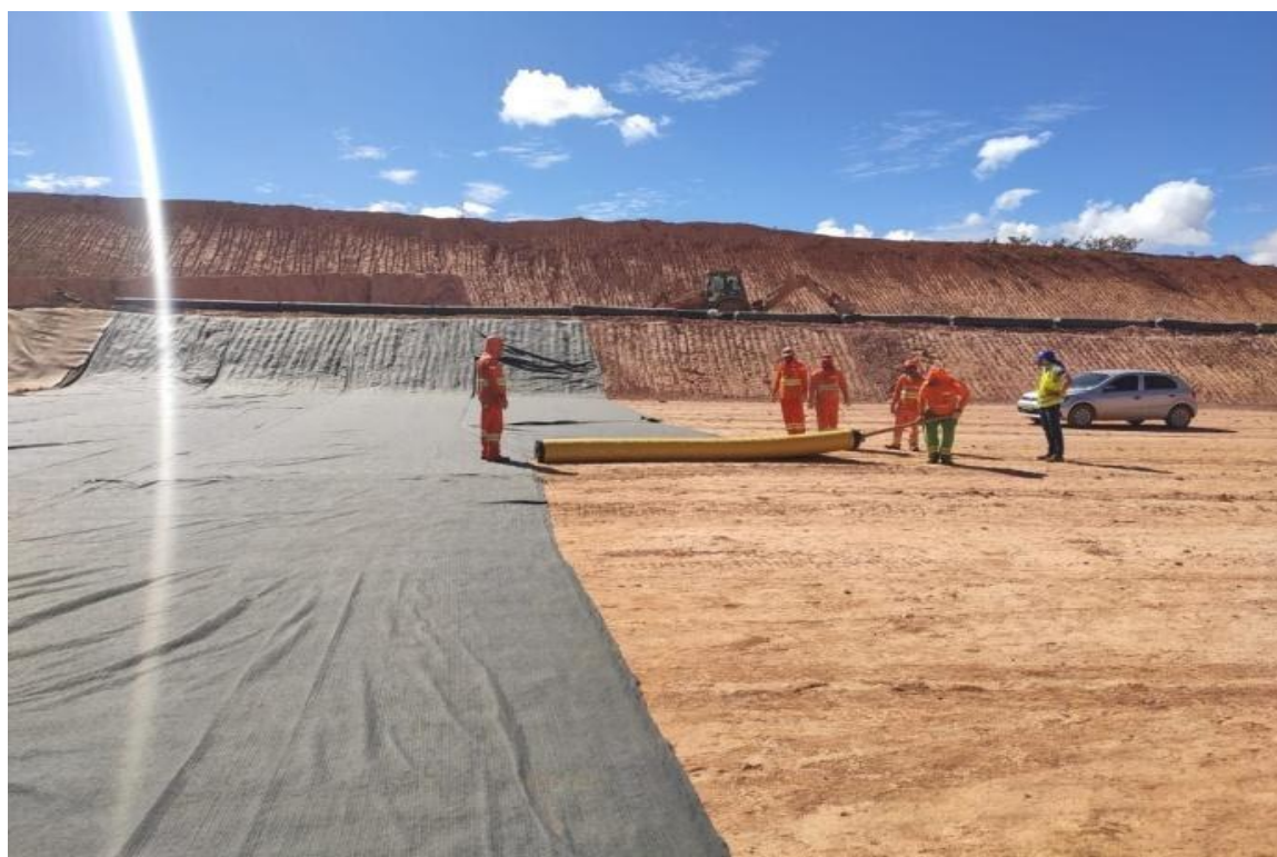
FIGURA 05 – Geocomposto beonítico (GCL) sendo instalado em unidade operacional da UVS VIASOLO MONTES CLAROS.
