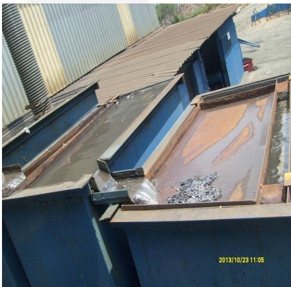
Foto 3: Tanques do sistema de lavagem a úmido
