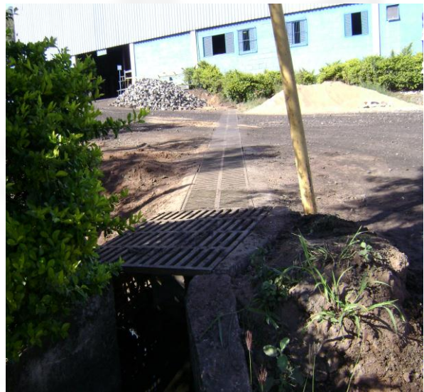
Foto 08: Sistema de drenagem pluvial
