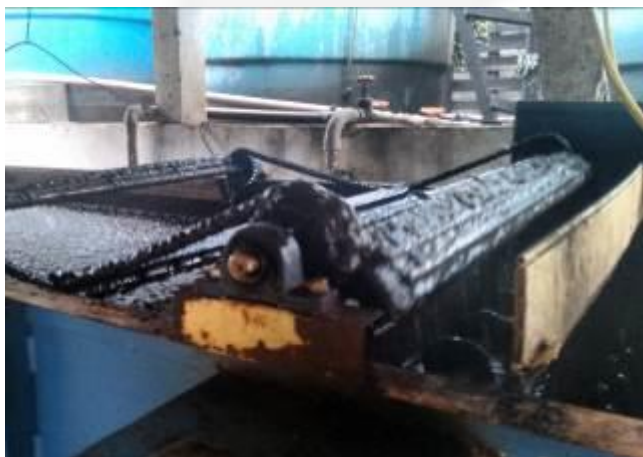
Foto 07. Flotador - ETE industrial
