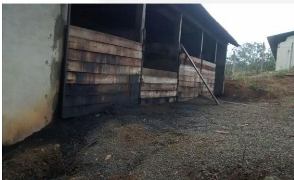
Foto 11: Vazamento do chorume da composteira.
