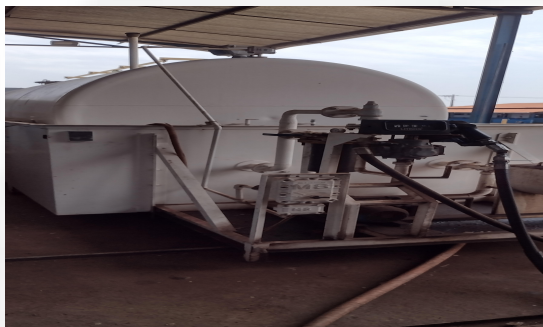
Tanque de combustíveis
