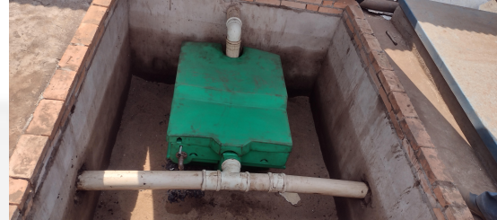
Caixa separadora de água e óleo
