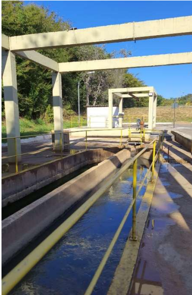
FOTO 1 – Tratamento preliminar e Estação Elevatória de Esgoto
