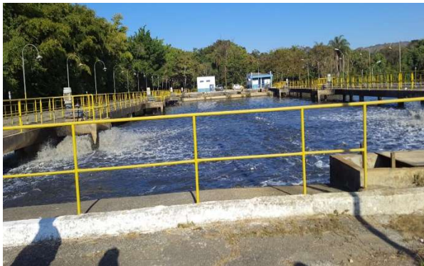
FOTO 3 – Tanque de aeração.
