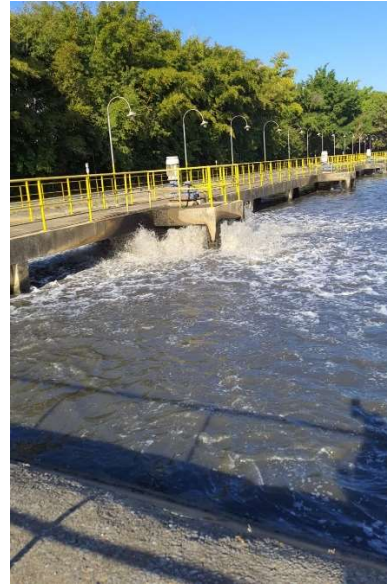
FOTO 2 – Tanque de aeração, iluminação e cortina arbórea ao fundo.
