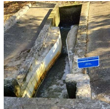
FOTO 4 – Calha Parshall - saída da ETE
