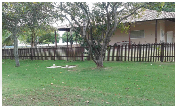
Foto 6. Casa sede (fossa séptica)
