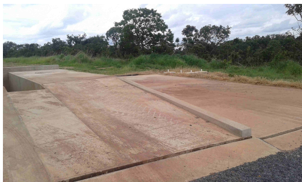
Foto 5. Lavador de máquinas e implementos
