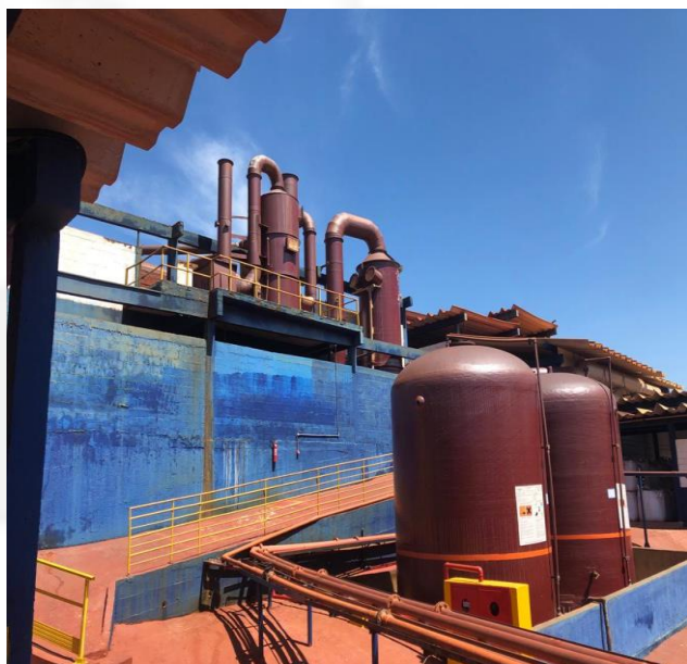
Foto 04. Vista do lavador de gases na parte superior da foto.
