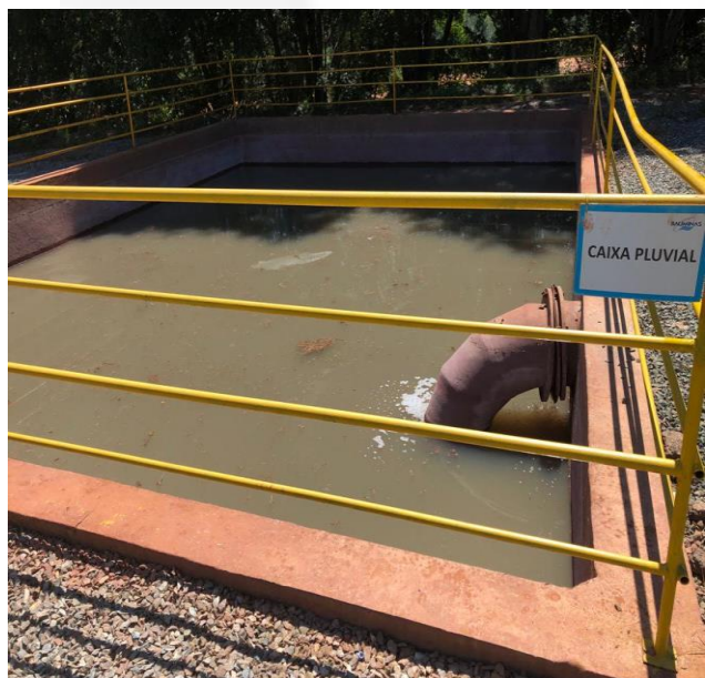
Foto 03. Caixa de contenção de rede de drenagem do para recirculação no processo produtivo.
