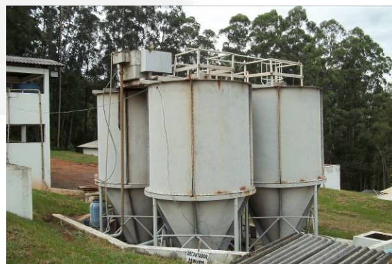
Foto 04. Tanques de precipitação da ETE.
