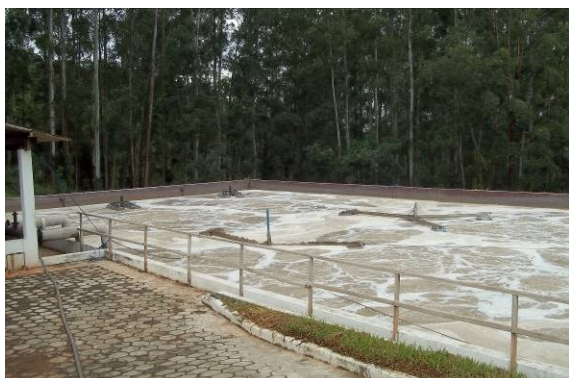
Foto 05. Aeração da ETE Industrial.
