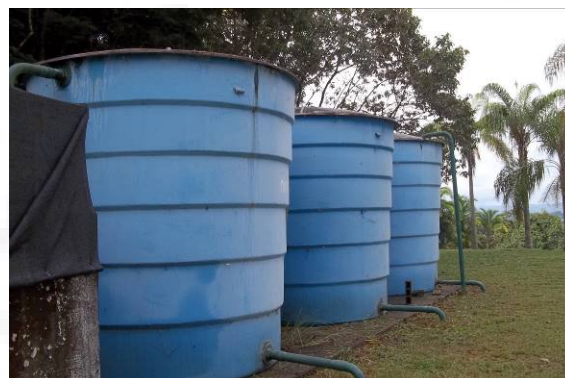
Foto 08. Caixas d'águas secundárias
