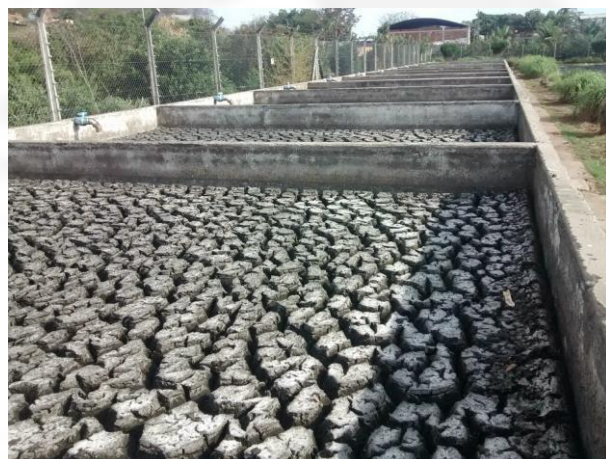
Foto 04. Leitos de secagem da ETE.
