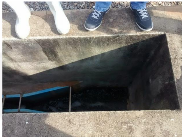
Foto 02. Local de saída do efluente da ETE.
