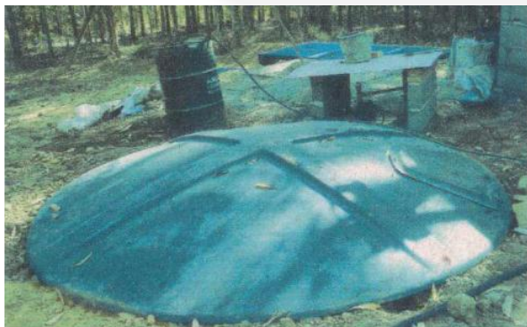
-Caixa pulmão da Estação de tratamento de esgotos Industriais (ETEI)
