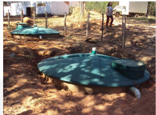
- Estação de tratamento de esgotos sanitários
