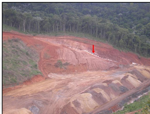
Foto 02: Em destaque canal de drenagem na PDE.
