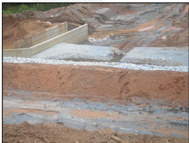
Foto 03: Final do dreno de fundo na PDE.
