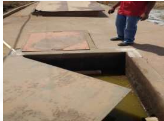
Foto 02. Caixa separadora de água e óleo
