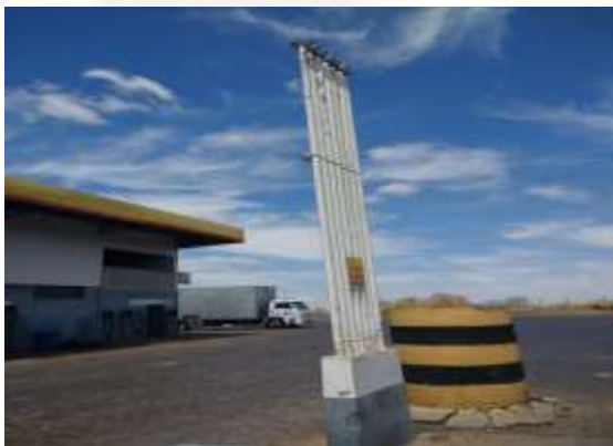
Foto 03. Respiro dos tanques
