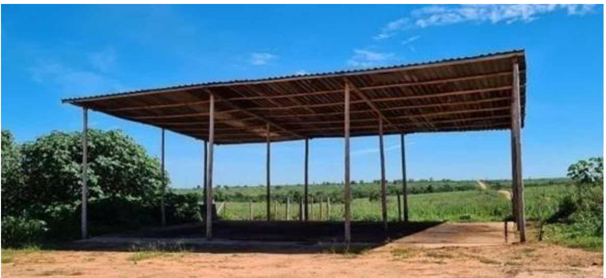
Figura 09: Pátio de máquinas PLC
