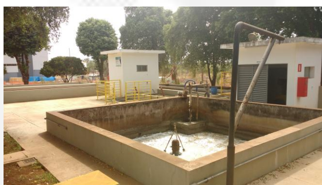
Foto 4 – Estação de Tratamento de efluentes
