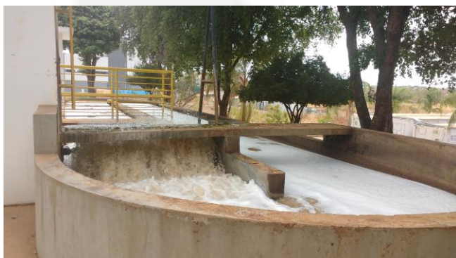
Foto 3 – Estação de Tratamento de efluentes
