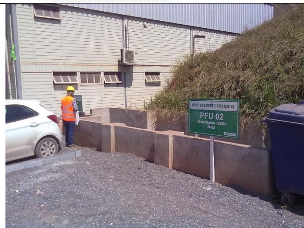
Fotografia 17: Sistema de Tratamento de efluentes Sanitários UTM. Vistoria 26/08/2015.
