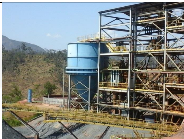
Fotografia 14: UTM implantada. Observa-se o cone desaguador. Vistoria 26/08/2015.
