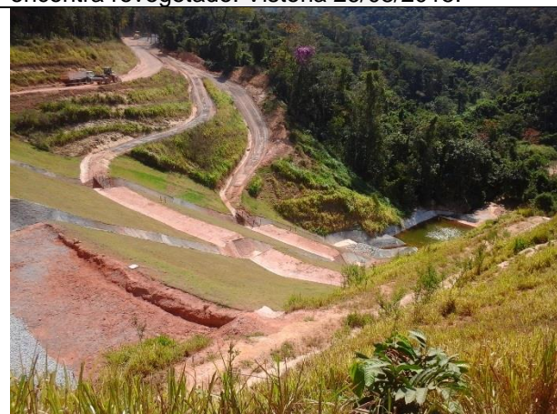
Fotografia 11: Barragem de rejeitos em operação. Observa-se o maciço do barramento e o dique de contenção de sedimentos. Vistoria 26/08/2015.
