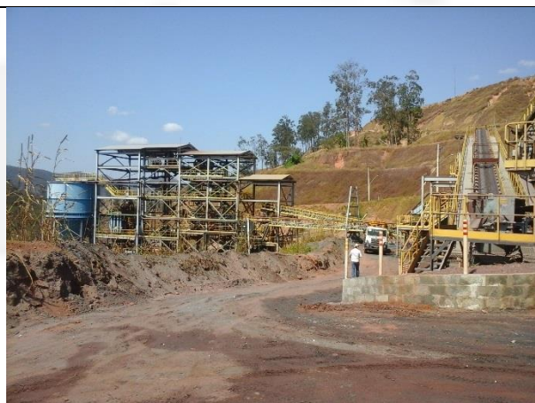
Fotografia 12: UTM implantada. Vistoria 26/08/2015.
