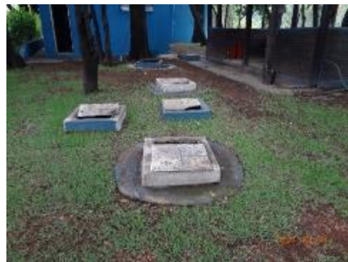
Foto 8: Fossa séptica dos banheiros com chuveiros e vestiário.
