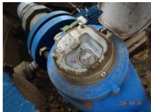
Foto 24: Hidrômetro do poço tubular 2.
