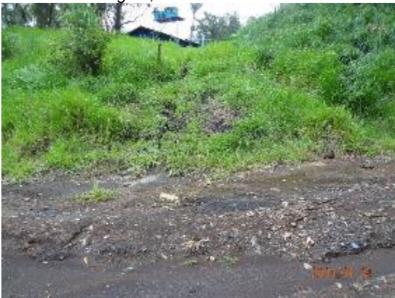
Bacia de decantação de água pluvial;
