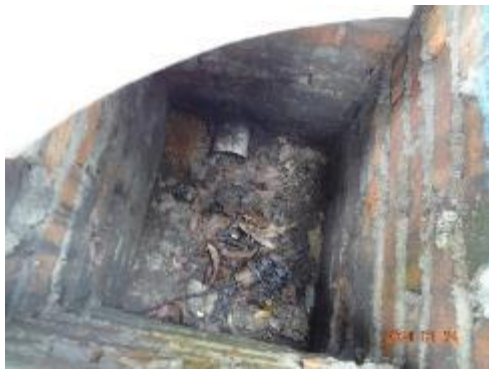
Foto 9: Detalhe de um dos compartimentos da fossa séptica atestando que esta estrutura não está sendo utilizada.
