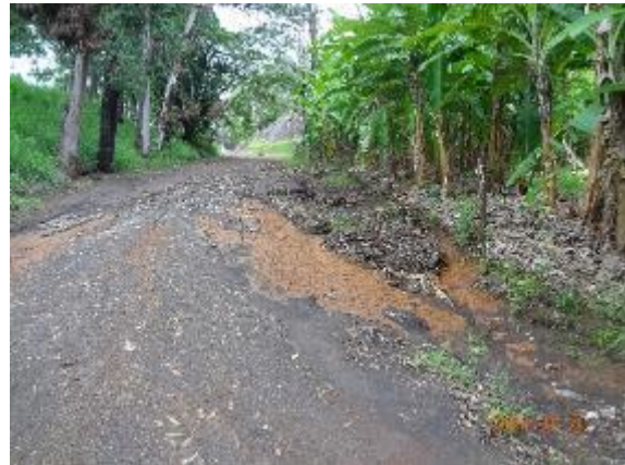
Foto 28: Carreamento de sedimentos ao longo do acesso seguindo em direção ao tanque de sedimentação.
