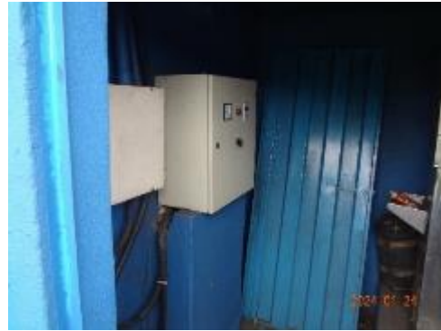
Foto 6: Painel de controle com horímetro do poço tubular 1.
