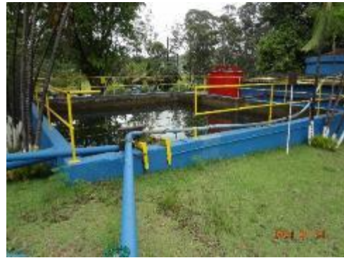
Foto 4: Tanque de resfriamento de água do processo.
