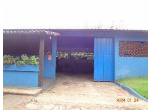
Foto 20: Piso da oficina com muitas trincas e sem canaleta.
