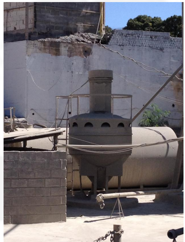
Foto 08. Filtro para contenção de poeiras, interligado aos silos de cimento.
