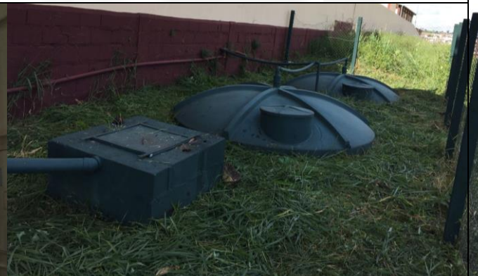
Foto 4: Sistema de tratamento de efluente sanitário.
