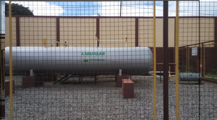
Foto 6: Central de armazenamento de gás GLP (Liquigás).
