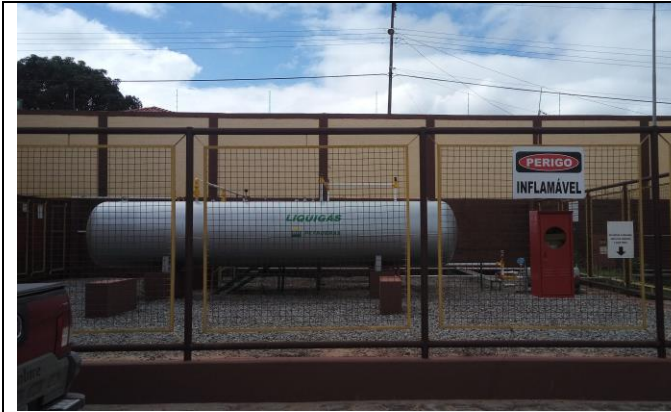
Foto 5: Central de armazenamento de gás GLP (Liquigás).
