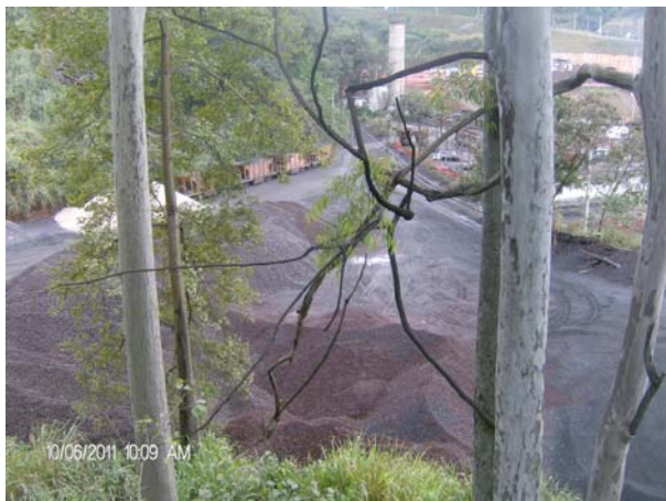
Foto 01. Área de instalação da nova planta (PL9) de separação de gases do ar.
