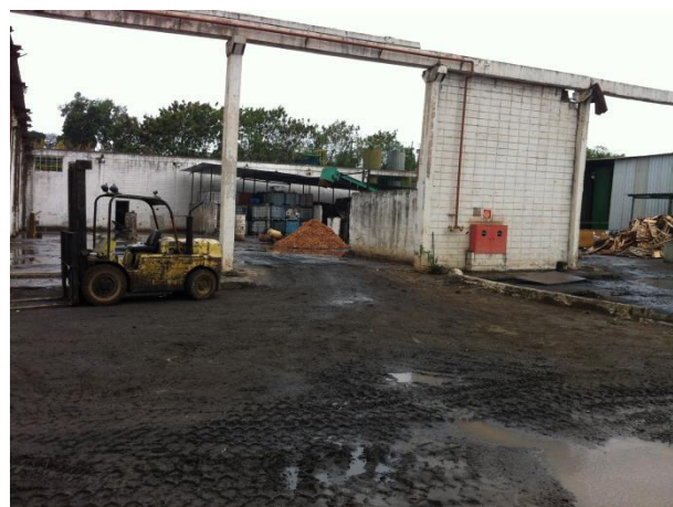
Foto 08. Galpão atualmente utilizado para depósito de biomassa. Local encontra-se destelhado após incêndio ocorrido na empresa. A empresa deverá providenciar a cobertura do galpão.
