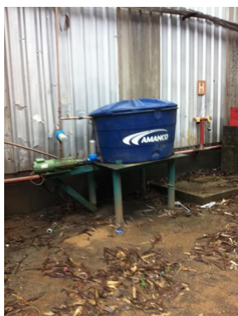
Foto 13. Caixa d' água para atendimento do sistema de desodorização.
