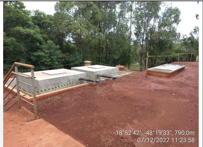
Foto 06 – UCE – Unidade de controle de efluentes
