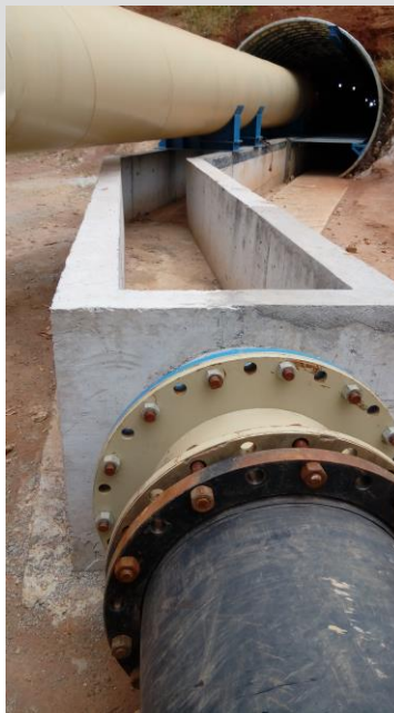
Estrutura de lançamento de rejeitos (canal em concreto seguido por tubo preto) e tubulação para recirculação de água (tubo bege).
