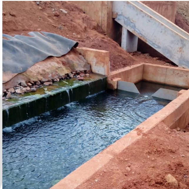
Dreno de fundo com medidor de vazão trapezoidal.
