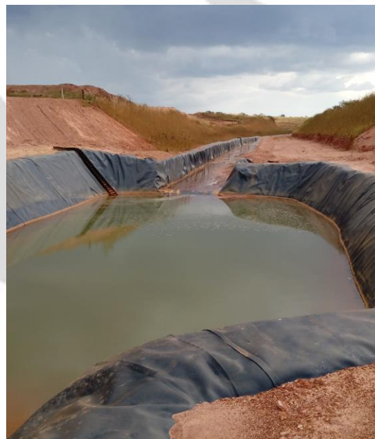
Sistema de drenagem pluvial e bolsão de sedimentação em manta PEAD.
