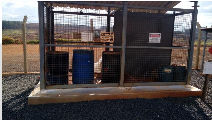
Baia para armazenamento temporário de resíduos oleosos.
