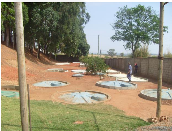
Foto 15: Estação de tratamento de efluentes líquidos.
