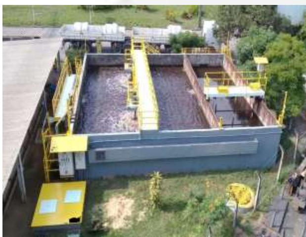
Figura 03. Estação de Tratamento de Esgoto.
